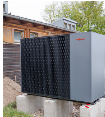
Diese Wärmepumpe am Sportplatz Heckerdamm sichert hohe Energie-Effizienz.
